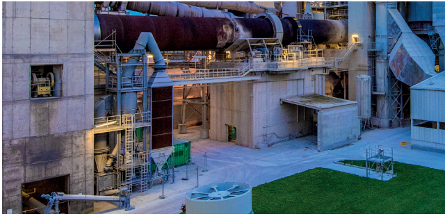
Pilotanlage Oxyfuel-Klinkerkühler, Zementwerk Hannover, HeidelbergCement Foto: Steffen Fuchs, Heidelberg/Deutschland
