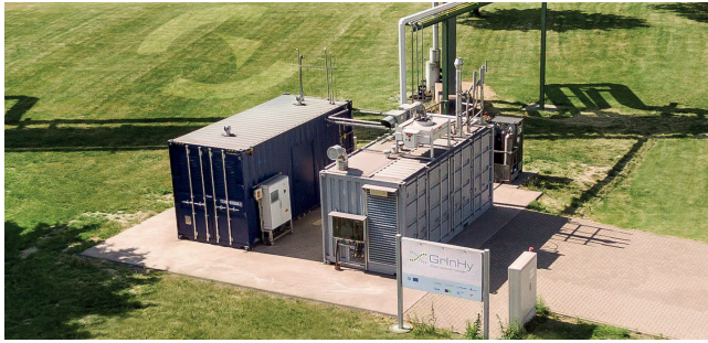
GrInHy-Pilotanlage zur Hochtemperatur-Elektrolyse, Salzgitter Foto: Salzgitter AG
